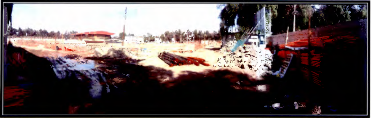
Foto 14: Materiales expuestos a la intemperie
