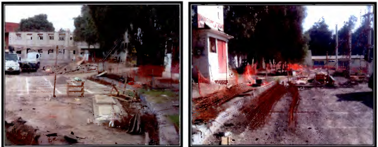
Foto 12 y Foto 13: La faena no está de libre de materiales
