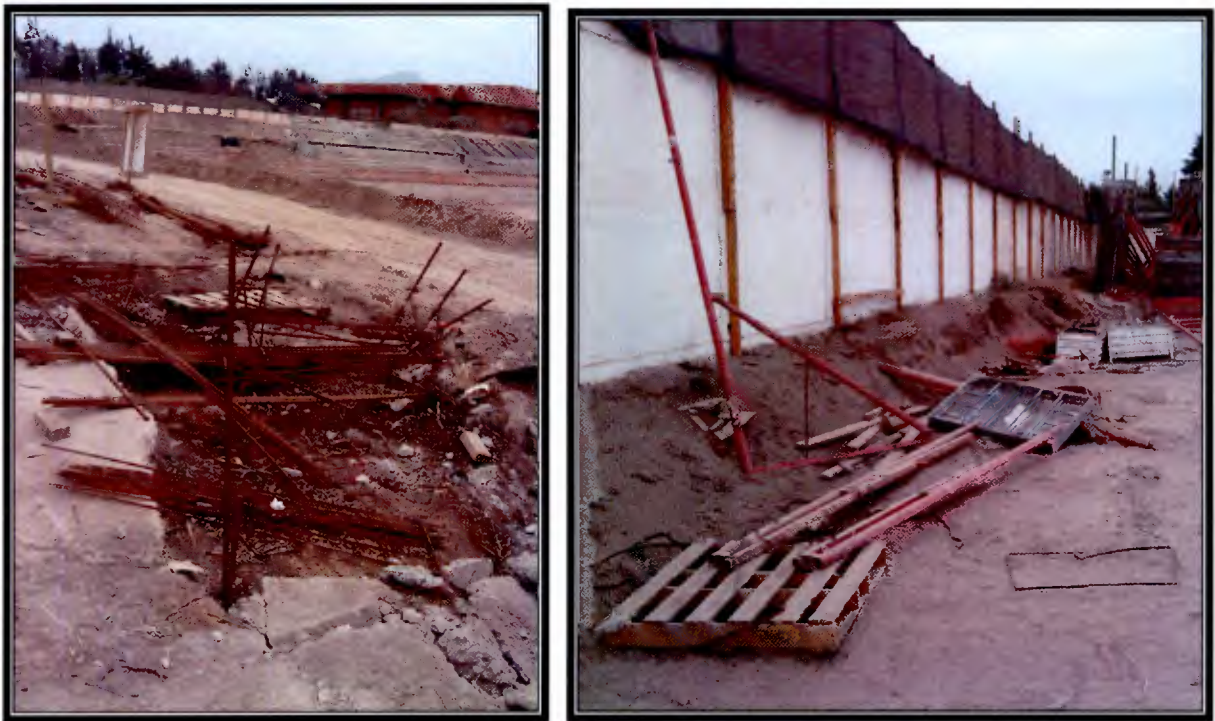
Foto 10 y Foto 11: Desechos que pueden ser peligrosos
