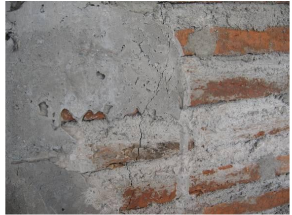
Foto N° 8: Ladrillos fisurados en muro de bodegas y estacionamientos, en la conservación de infraestructura apoyo, Región Metropolitana.
