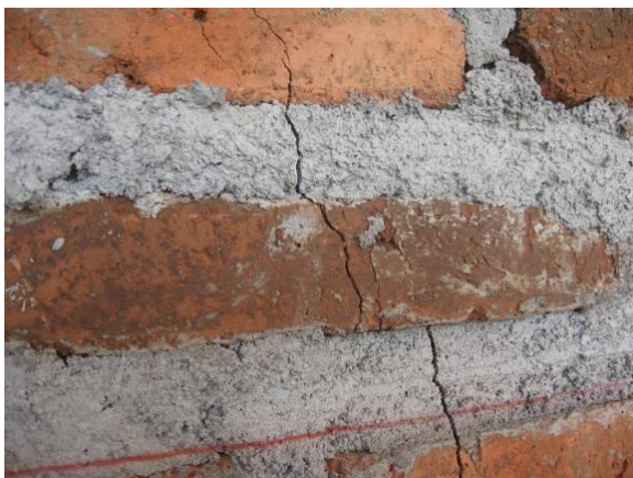
Foto N° 9: Ladrillos fisurados en muro de bodegas y estacionamientos, en la conservación de infraestructura apoyo, Región Metropolitana.
