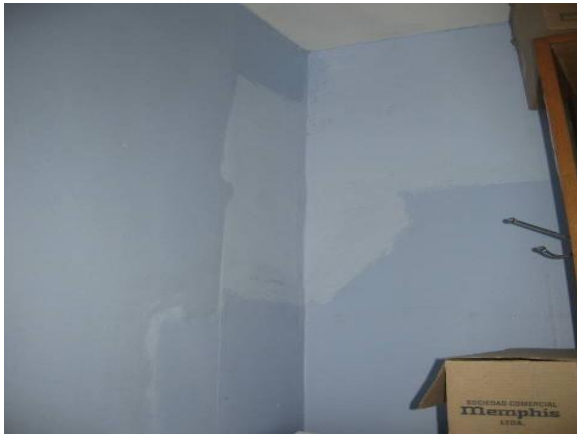
Foto N° 7: Pintura incompleta en oficina Vialidad Moneda, en la conservación de infraestructura apoyo, Región Metropolitana.
