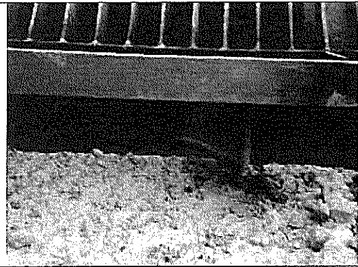
Foto N° 20: Fierro de anclaje embutido una distancia menor.
