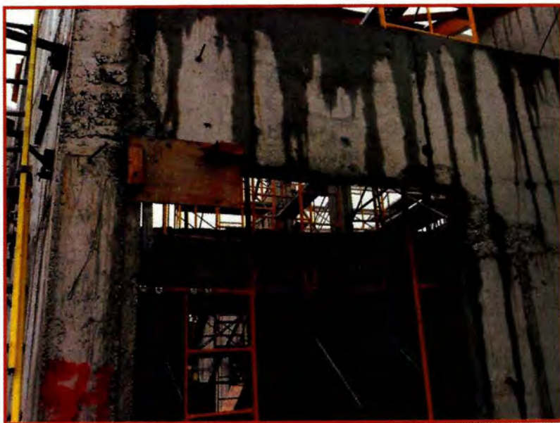
Fotografía N° 1, nido de piedras en muro pasillo, eje I, entre ejes 1 y OA, Módulo de Servicios (F).
