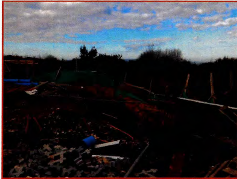
Fotografía N° 1. Cierre perimetral y ausencia de señalización de peligro de caída, sector Poniente (vegas).
