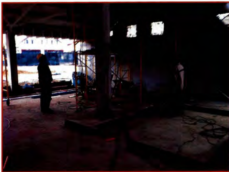
Fotografía N° 12, Trabajador sin uso de casco de seguridad.
