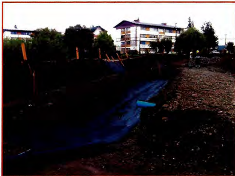
Fotografía N° 10, Ausencia de señalización de peligro de caída, sector Poniente (vegas).
