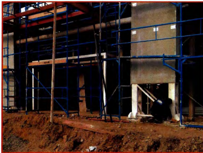
Fotografía N° 2. Trabajador sin uso de casco de seguridad.
