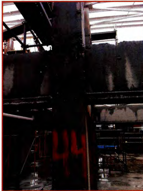
Fotografía N° 6, nido de piedras en pilar, eje I Módulo Administración y Taller (E).
