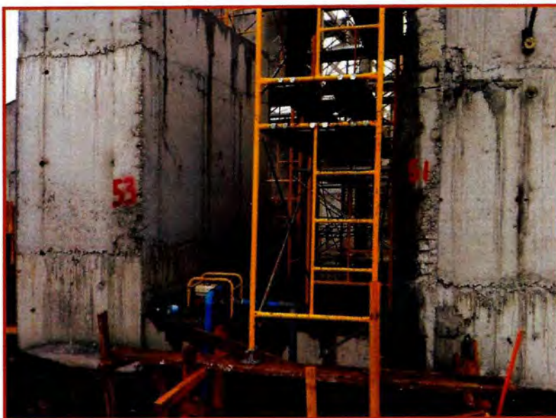
Fotografía N° 2, nido de piedras en muro, eje OA, Módulo de Servicios (F).
