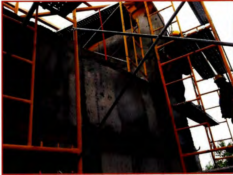
Fotografía N° 3, nido de piedras en muro pasillo, eje I, entre ejes 1 y OA, Módulo de Servicios (F).
