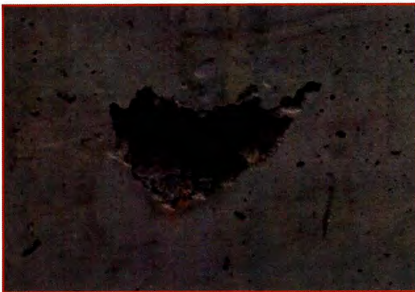
M D Fotografía N° 8, Recubrimiento de armadura insuficiente (aproximadamente 1 cm), muro eje 8, entre ejes I y P. Módulo Administración y Taller (E).
