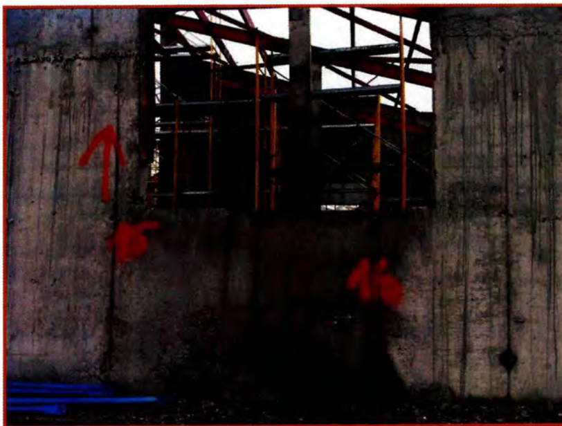
Fotografía N° 7, nido de piedras en muro, eje 4, entre ejes I y P.
