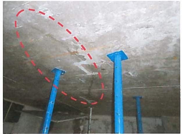
Fotografía N°13 Lugar: Eje 8b – 10 y A - B, Cielo 2 do Subt. Detalle: Losa de hormigón presenta fisura. Fecha: 04.07.12
