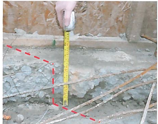
Fotografía N°22 Lugar: Eje H1 entre los ejes 11b – 12, nivel -7,75 del Edificio Moneda Bicentenario. Detalle: Existe una diferencia de nivel de piso terminado de 20 cm entre el edificio de la Contraloría General de la República y el nivel -7,75 del Edificio Moneda Bicentenario. Fecha: 05.07.12
