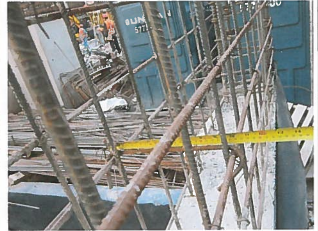
Fotografía N°26 Lugar: 4° Subt., muro en eje G2, entre Ejes 6-A y 7-C. Detalle: Traba de largo 27 cm de largo, lo cual permite espesor mínimo de 1.5 cm, de acuerdo con plano de terreno. Fecha: 15.05.12
