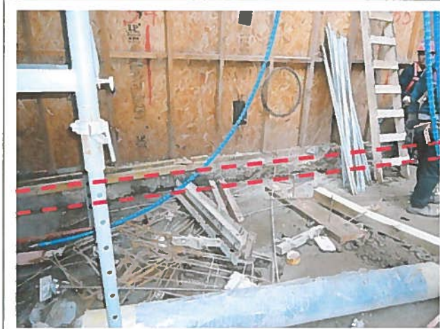
Fotografía N°21 Lugar: Eje H1 entre los ejes 11b – 12, nivel -7,75 del Edificio Moneda Bicentenario. Detalle: Existe una diferencia de nivel de piso terminado de 20 cm entre el edificio de la Contraloría General de la República y el nivel -7,75 del Edificio Moneda Bicentenario. Fecha: 05.07.12
