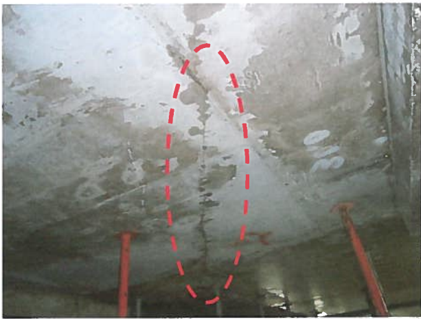
Fotografía N°7 Lugar: Eje 4-5 y G1, Cielo 2 do Subterráneo. Detalle: Losa de hormigón presenta fisura. Fecha: 28.06.12
