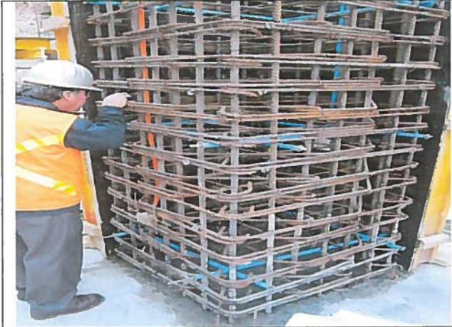
Fotografía 21 Lugar: 4° Subt., Pilar cruce Eje E-1 y 3-A Detalle: 7 fierros de 25 mm., de acuerdo con el plano de terreno. Fecha: 15.05.12
