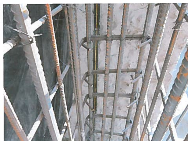
Fotografía N°19 Lugar: 4° Subt., En cabezal de encuentro de Eje A con eje 10. Detalle: 4 fierros de 22 mm. de acuerdo con plano de terreno. Fecha: 15.05.12
