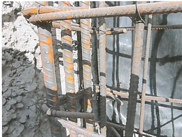
Fotografía N°16 Lugar: 4° Subt., en eje A, entre pilas 4 y 5. Detalle: 4 fierros de 22 mm. en cabezales de muro de acuerdo con plano de terreno. Fecha: 15.05.12
