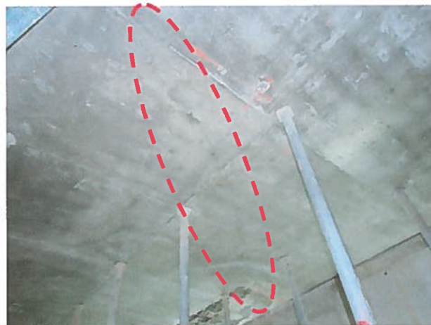
Fotografía N°16 Lugar: Eje 10a – 11b y G3 – H1, Cielo 2 do Subt. Detalle: Losa de hormigón presenta fisura. Fecha: 04.07.12
