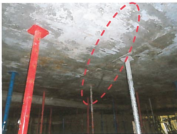
Fotografía N°14 Lugar: Eje 8b – 10a y C - E, Cielo 2 do Subt. Detalle: Losa de hormigón presenta fisura. Fecha: 04.07.12
