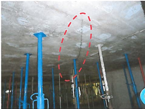
Fotografía N°12 Lugar: Eje 8b – 10 y A - D, Cielo 2 do Subt. Detalle: Losa de hormigón presenta fisura. Fecha: 04.07.12
