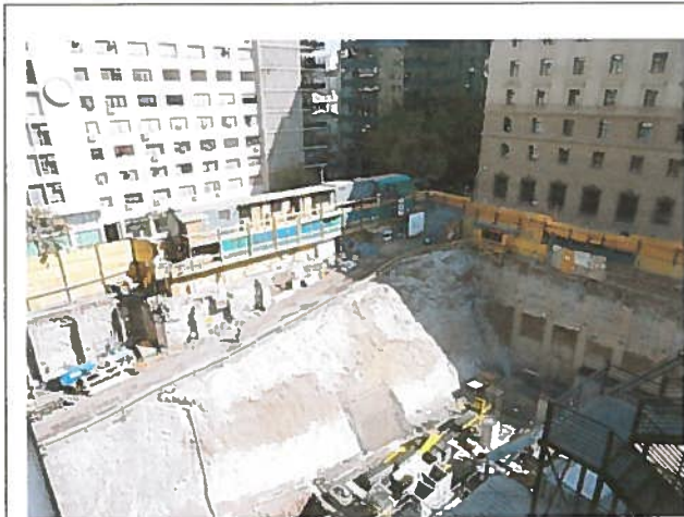
Fotografía N°1: Falta material por extraer correspondiente a la etapa 2, el cual conforma un terraplén utilizado para acceder a las faenas: Fecha: 23.03.2012.
