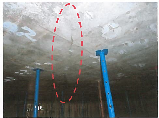
Fotografía N°15 Lugar: Eje 8b – 10a y C - E, Cielo 2 do Subt. Detalle: Losa de hormigón presenta fisura. Fecha: 04.07.12
