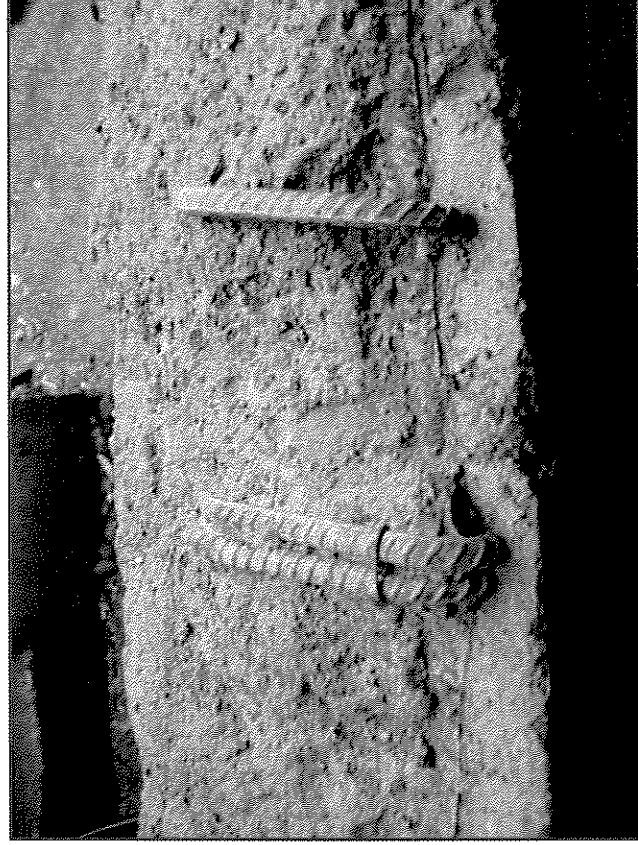
Fotografía N° 7, recubrimiento deficiente en rasgo de alfeizar en ventana de recinto de cocina 1er piso
