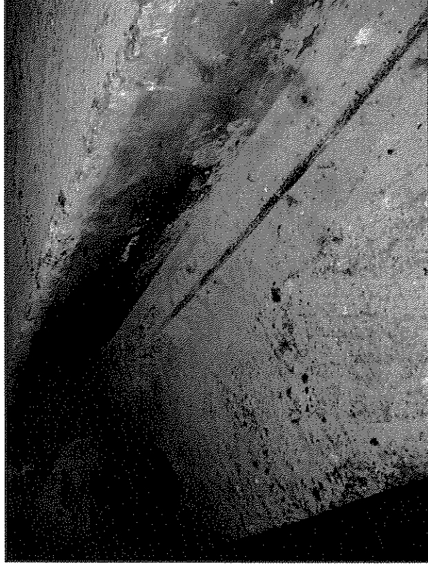
Fotografía N° 11, recubrimiento deficiente con armadura a la vista y presencia de corrosión en huella de peldaño en escala adjunta a caja de ascensor. (1er piso)
