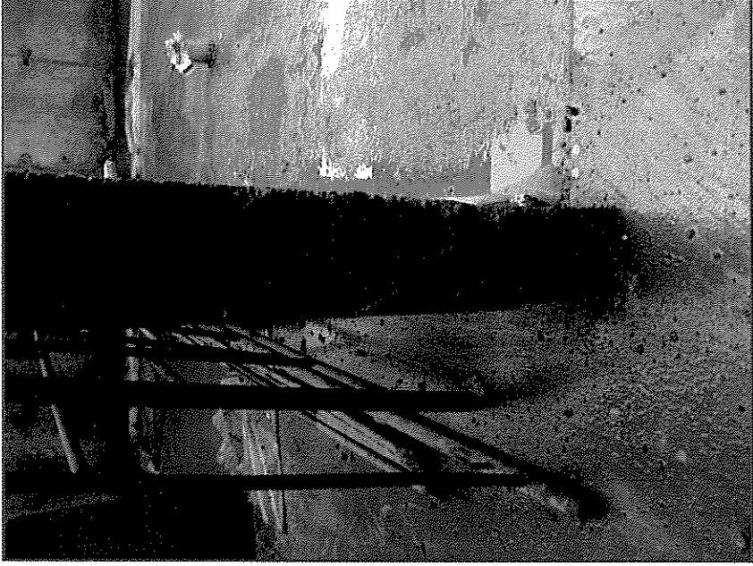
Fotografía N° 15, muro con angostamiento hacia la base. (Baños alumnos, 1er piso)
